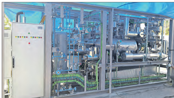
Опытная установка риформинга метанола фирм ТКМС и «SENER Дефенсе»
